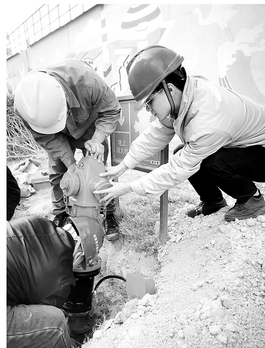
受地理环境潮湿、盐分大的影响,经过5年的长期运行,晋南热电公司的露天消防设施锈蚀情况较为严重。经过一个月的施工,12月20日,晋南热电全厂的露天消防栓和所有建筑楼顶的蝶阀全部更换完成。(周国利 摄)
